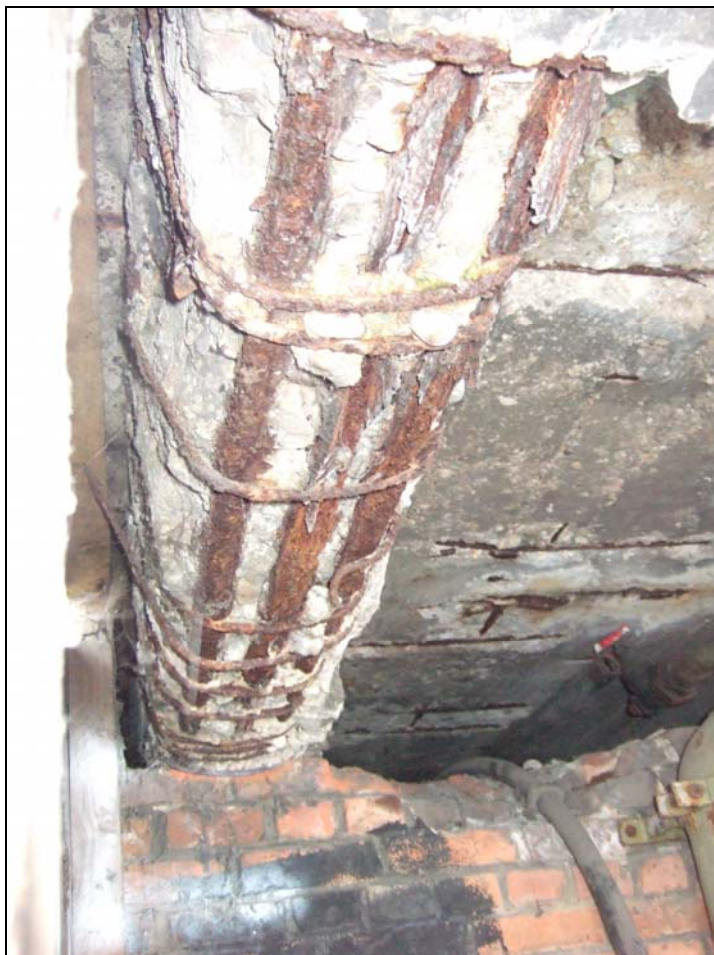
Foto 8: De steunbalken aan de onderzijde van het dek zijn volledig gecorrodeerd
