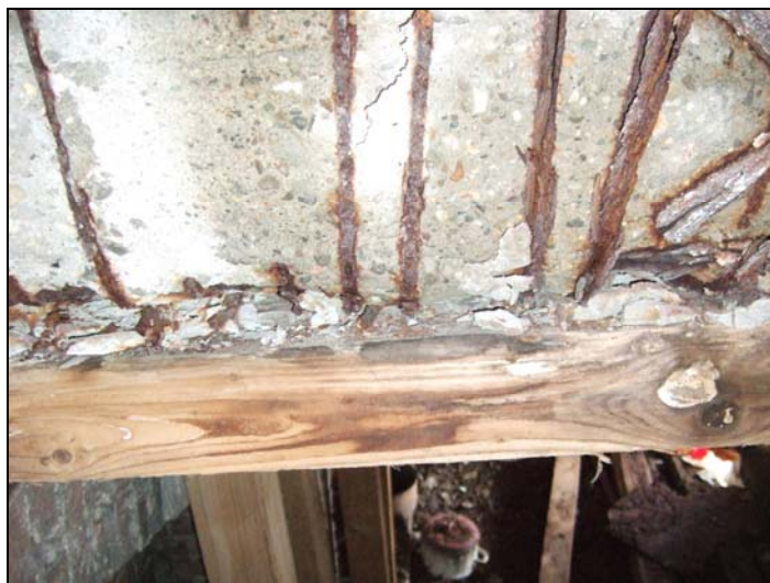
Foto 6: De onderzijde van het dek is volledig gecorrodeerd.
