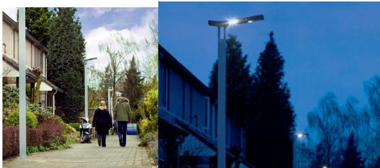
Figuur 21 Energie-efficiënte LED verlichting 6
